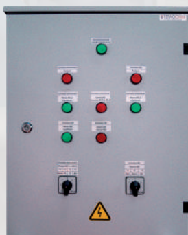
ШКАФЫ УПРАВЛЕНИЯ ТШУ
